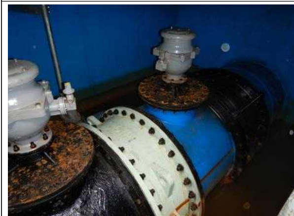
⑤ 조명 미설치 구조물 내부 현황
