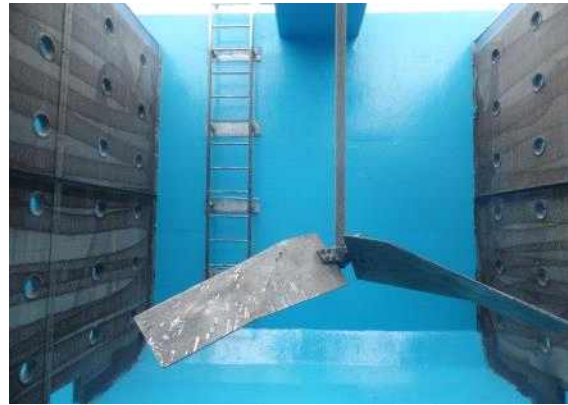
② 수처리구조물 내부진입 시 사다리 설치현황
