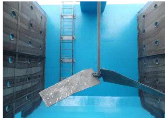
② 수처리구조물 내부진입 시 사다리 설치현황
