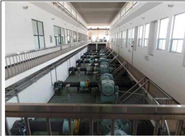
① 토목구조물(배관실) 각종 설비 설치현황
